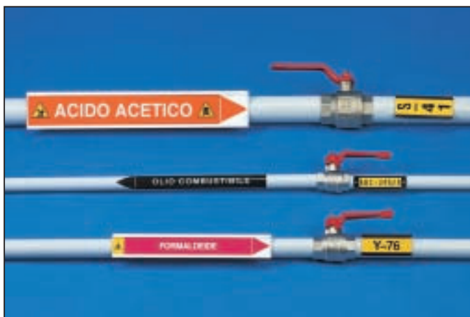
tubazioni con sistema TLS
